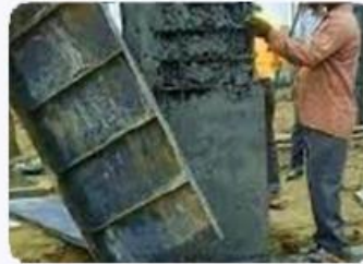
Columnas mal vaciadas
